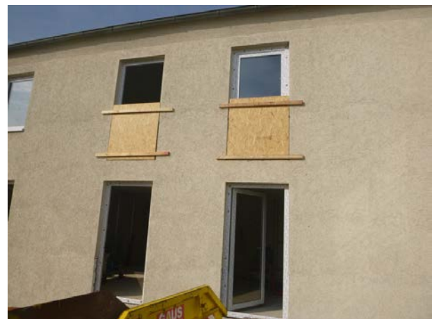
im laufenden Betrieb – Absturzicherungen im Bereich der Fensterbrüstungen.
